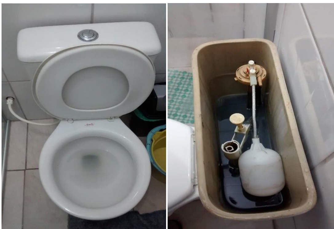
Figura 5: Bacia sanitária e caixa acoplada (Fonte: Elaborado pelas autoras, 2017).
