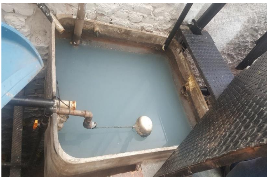
Figura 4: Caixa para armazenamento da água do tanque (Fonte: Elaborado pelas autoras, 2017).
