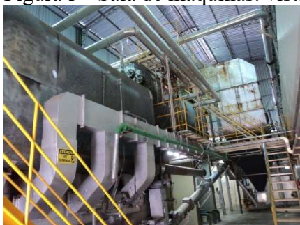
Figura 5 - Sala de máquinas: vista externa da caldeira.
